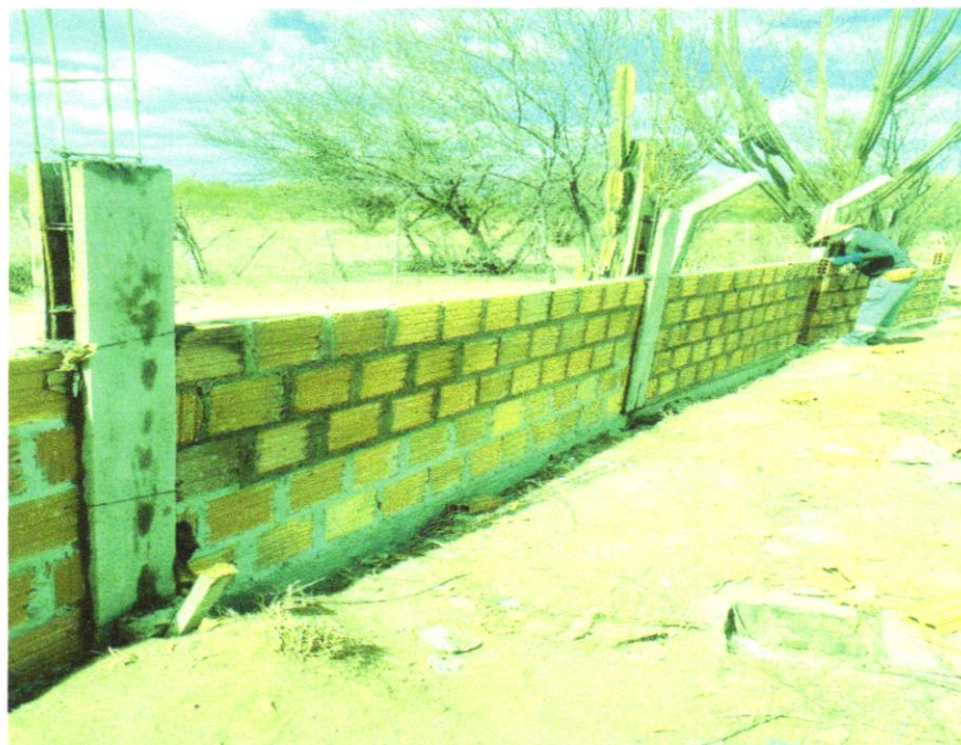
Foto 01 - ALVENARIA DE VEDAÇÃO DE BLOCOS CERÂMICOS FURADOS NA VERTICAL DE 9X19X39 CM (ESPESSURA 9 CM) E ARGAMASSA DE ASSENTAMENTO COM PREPARO EM BETONEIRA. AF_12/2021
